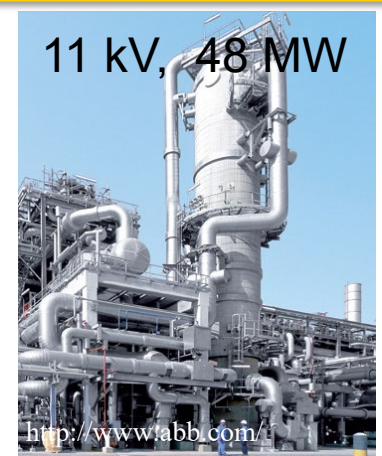
LNGコンプレッサ
